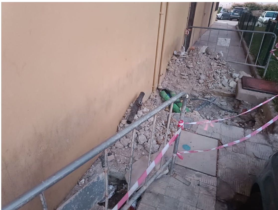
Imagen del socavón en la zona / IU
