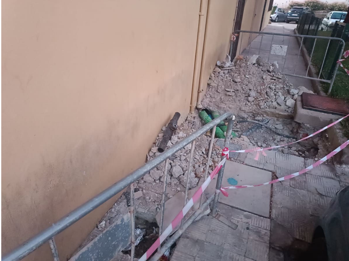
Imagen del socavón en la zona / IU
